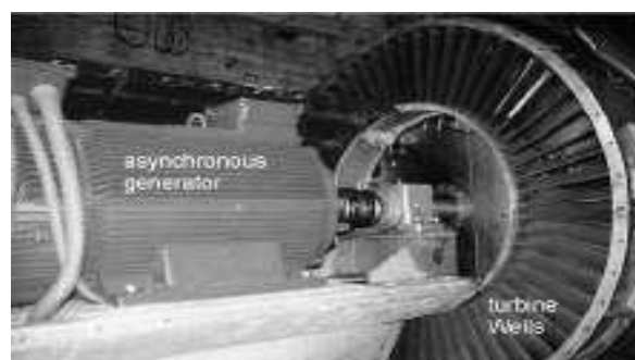
Fig. 6 Generator / rectifier air turbine group
